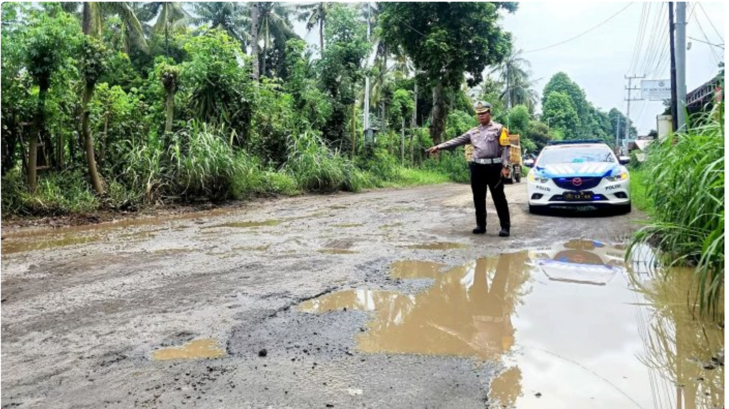
Kasatlantas Polresta Banyuwangi Kopol Amar Hadi Susilo menunjukkan jalan Lingkar Ketapang yang mengalami kerusakan dan berlubang
